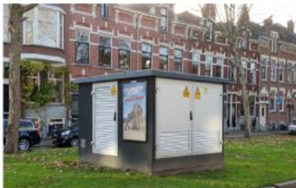
7x Transformatorhuisje 15m 2 /stuk
